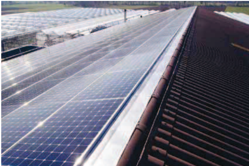
Cette installation réalisée sur le domaine Bioland de Stephan Müller, Steinmaur ZH, atteint une puissance de crête de 174,72 kWc et couvre une surface de référence de 893 m 2 .
