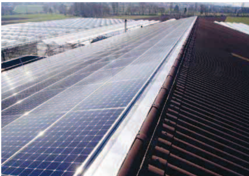
Diese Anlage auf dem Betrieb Bioland von Stephan Müller, Steinmaur ZH, erreicht eine Spitzenleistung von 174,72 kWp und umfasst eine Bezugsfläche von 893 m 2 .
